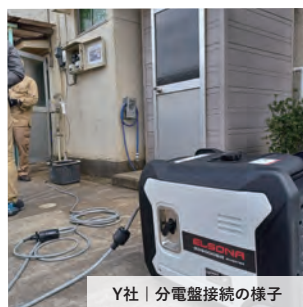
Y社 | 分電盤接続の様子
