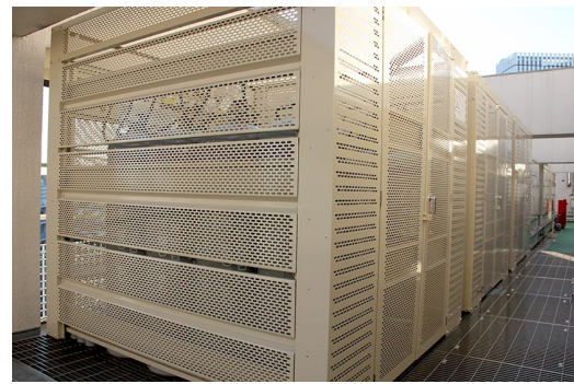
非常時には、50kg 容器40本で発電機3系統にLPガスが供給される
